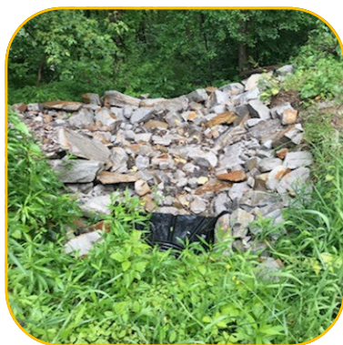
R7 RipRap apron
